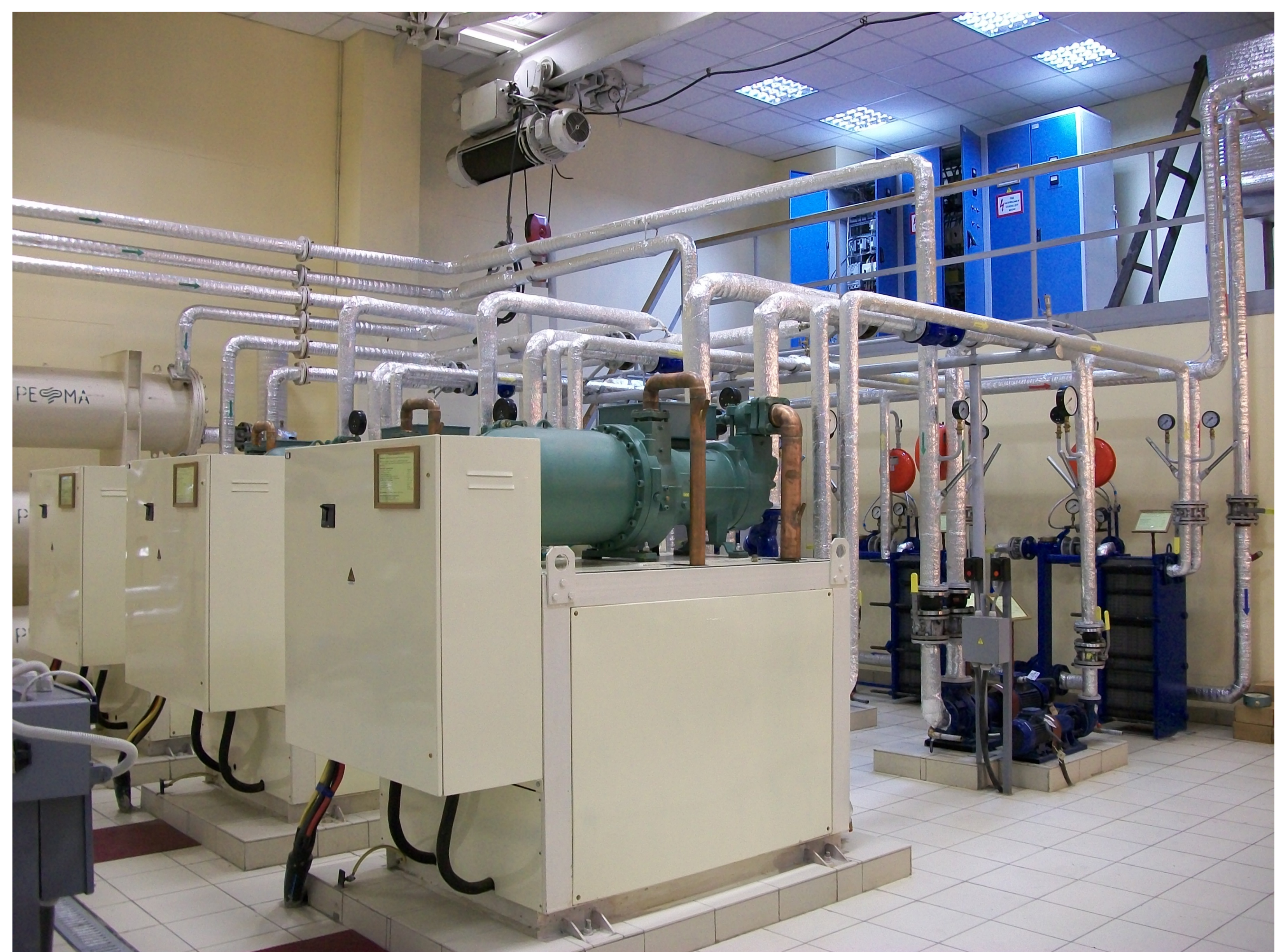
Теплонасосна установка ТНУ-800 на ПСП „Шахта „Благодатна“ ПАТ „ДТЕК Павлоградвугілля“
